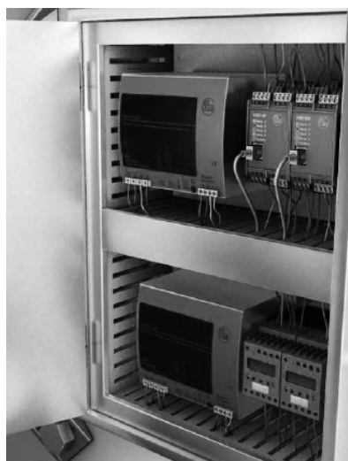
Slika 3. Elektroormar nadzorno-dijagnostičkog sistema vjetroelektrane [5] Figure 3. Electrobox of monitoring system at wind power [5]
