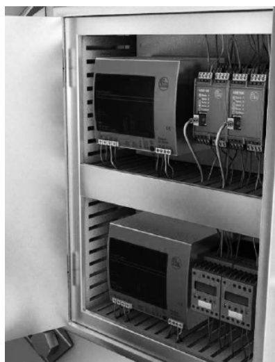
Slika 3. Elektroormar nadzorno-dijagnostičkog sistema vjetroelektrane [5] Figure 3. Electrobox of monitoring system at wind power [5]
